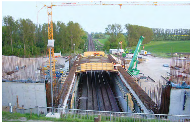
Bild 6 Herstellung der Rahmenstiele und -riegel der einschiffigen Kanalbrücke Constructing the supporting and horizontal members of the bypass bridge
