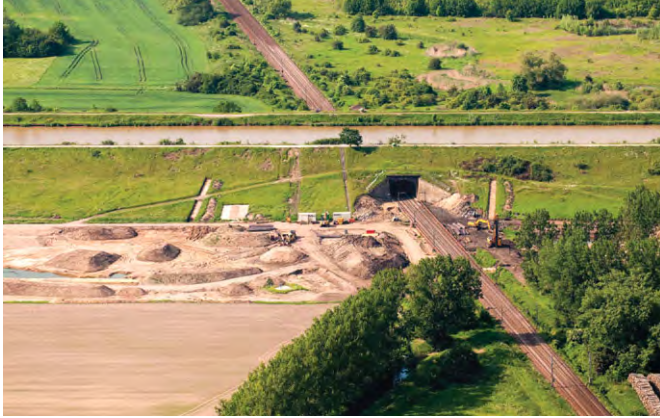
Bild 2 Die Kanalüberführung Elbeu vor Beginn der Bauarbeiten The flyover Elbeu before starting the construction works
