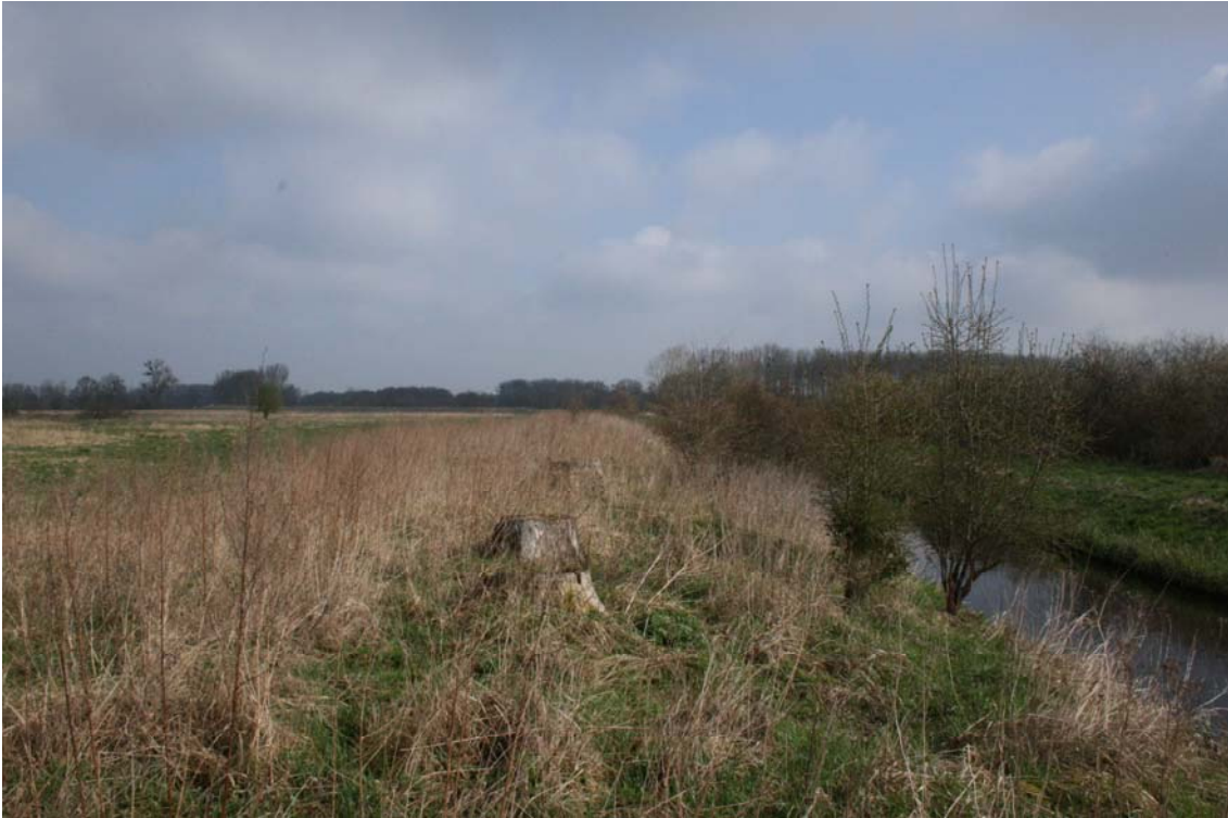
Abb.13: Der Südteil des Allerhochwasserentlasters (B1) von Süd nach Nord. (Aufnahme: H.-G. BENECKE, 08.04.2008)
